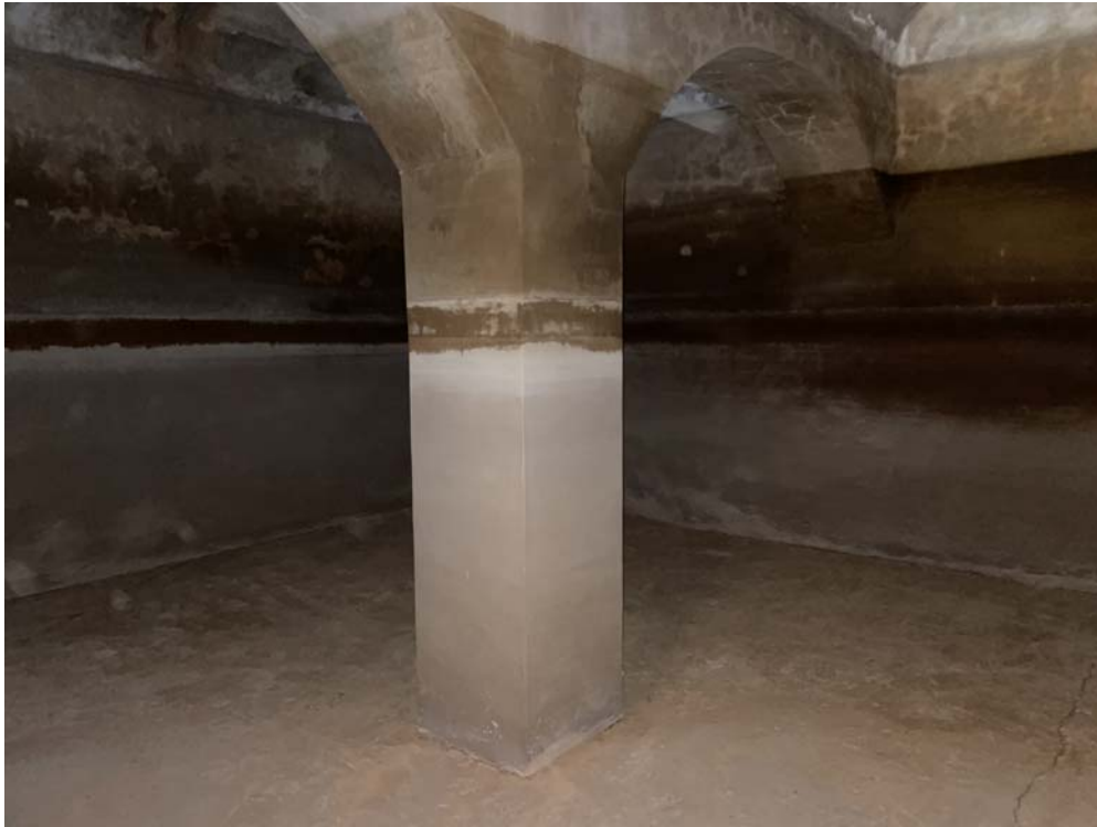
Fotografía nº3.- Interior del depósito pequeño, que está vacío. A la derecha se observa la grieta en el suelo.
