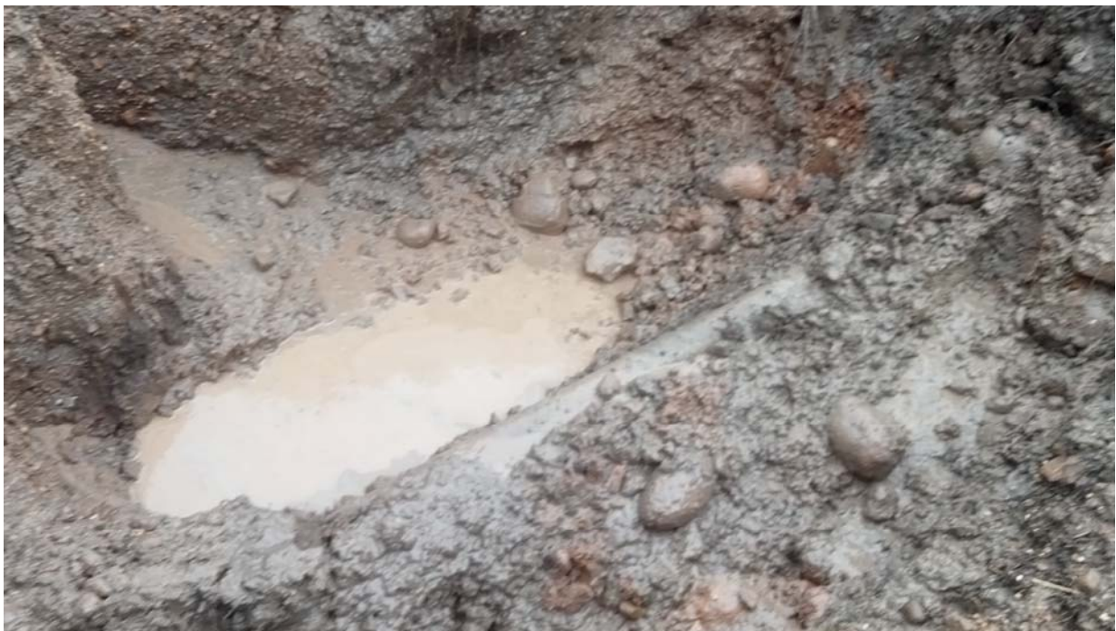
Fotografía nº7.- Fuga del día 28 de noviembre de 2.022 en la tubería de fibrocemento de bajada desde el depósito hacia el casco urbano.
