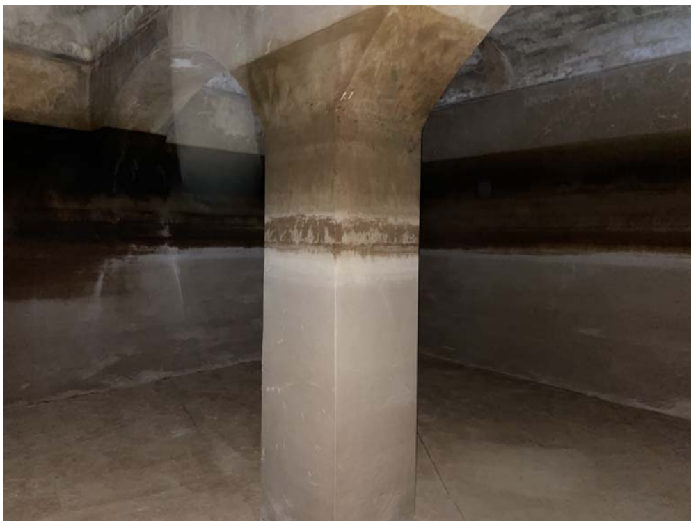
Fotografía nº4.- Interior del depósito pequeño. Se observan más grietas en el suelo.
