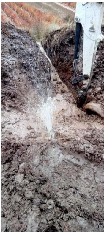
Fotografía nº6.- Fuga del día 28 de noviembre de 2.022 en la tubería de fibrocemento de bajada desde el depósito hacia el casco urbano.
