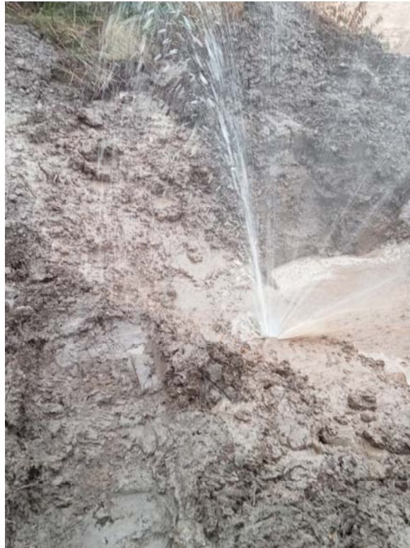
Fotografía nº7.- Fuga del día 28 de noviembre de 2.022 en la tubería de fibrocemento de bajada desde el depósito hacia el casco urbano.
