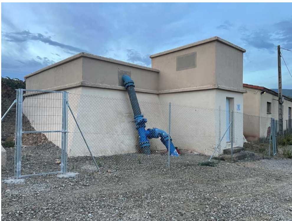
Fotografía nº1.- Exterior depósito pequeño que no se está utilizando debido a la cantidad de fugas que tiene. Se observa la tubería con la que hicieron un by-pass al depósito para que el agua fuese directamente al segundo depósito.
