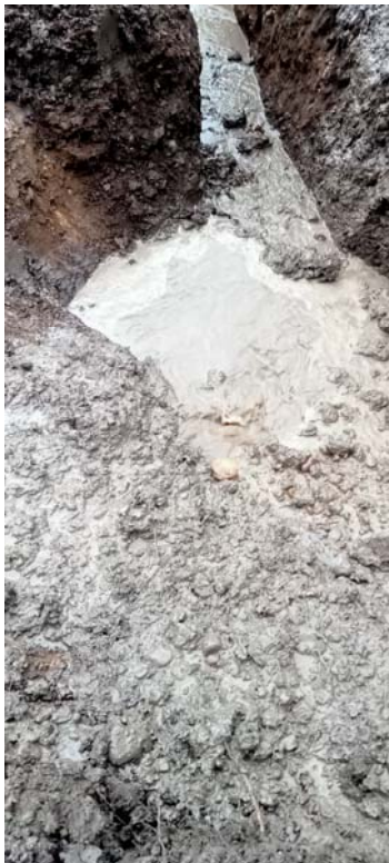
Fotografía nº5.- Fuga del día 28 de noviembre de 2.022 en la tubería de fibrocemento de bajada desde el depósito hacia el casco urbano.
